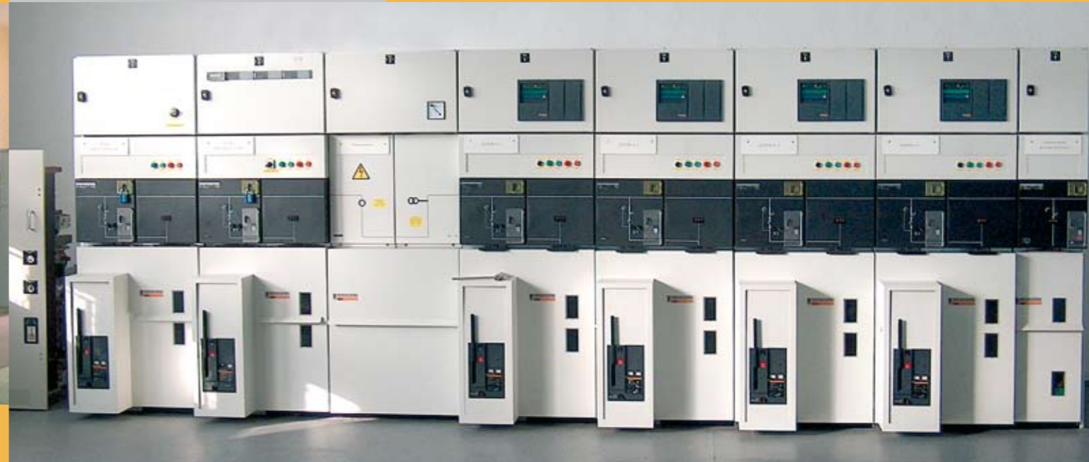
Stacja prostownikowo-trakcyjna MPK Wrocław-Grabowa
